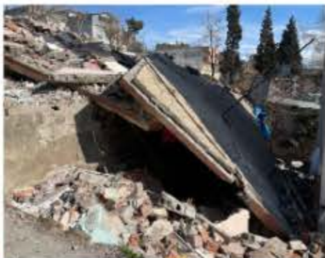
写真11 屋根スラブが最下段まで落下した様子
