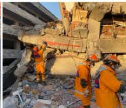
写真16 ひび割れをマーキングしてモニタリング
