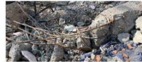
写真3 柱のせん断補強筋と抜け出した主筋
